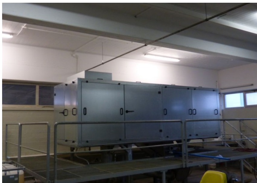
Neuer Decanter nach der Schallschutz-Umhüllung
