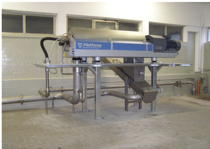
Neuer Decanter zur Schlammentwässerung
